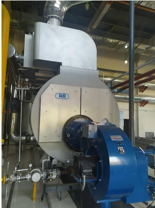
图4-3 锅炉及燃烧器
